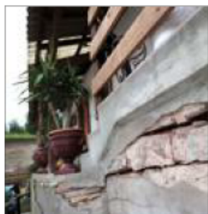
Le mur endommagé d'une maison ancienne.
