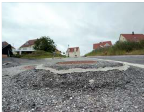
La chaussée du nouveau quartier du village s'est soulevée de plusieurs dizaines de centimètres. Photos AFP/Frédéric Florin
